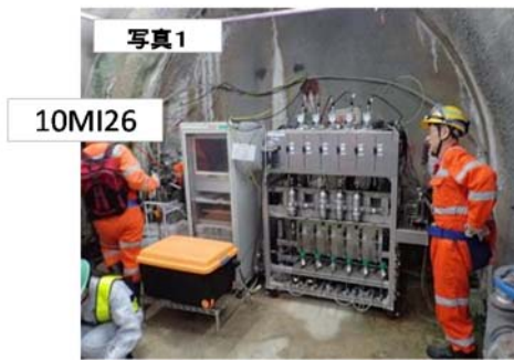
【別図 5. 24】 深度 400m における撤去対象の観測機器
